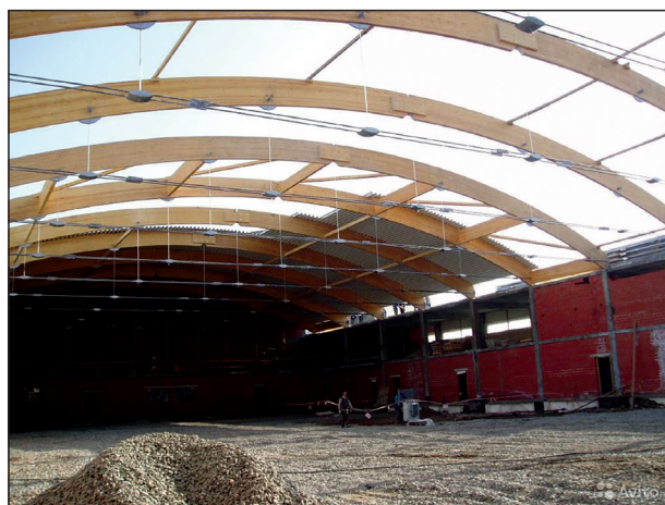
Рис. 3. Арочные большепролетные клееные деревянные конструкции
