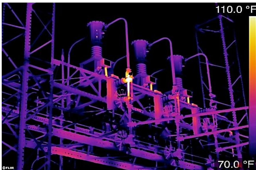
Рис. 1. Вид ЛЭП в тепловизионном сенсоре
